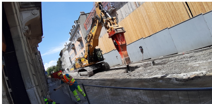
Démolition de la structure du tram à l'aide d'une pelle mécanique de 100 tonnes
